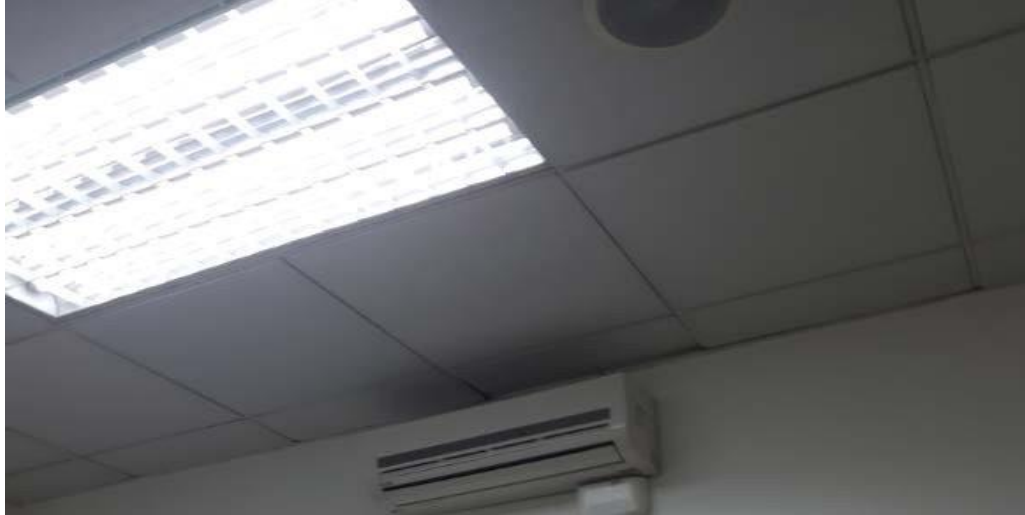
Luminárias que serão reaproveitadas/relocadas conforme projeto
