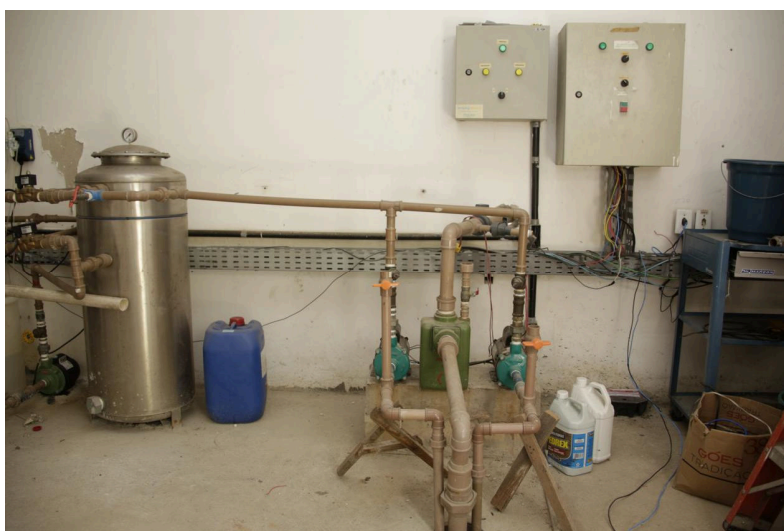
Figura 9 – Estação de tratamento e utilização de água da chuva
