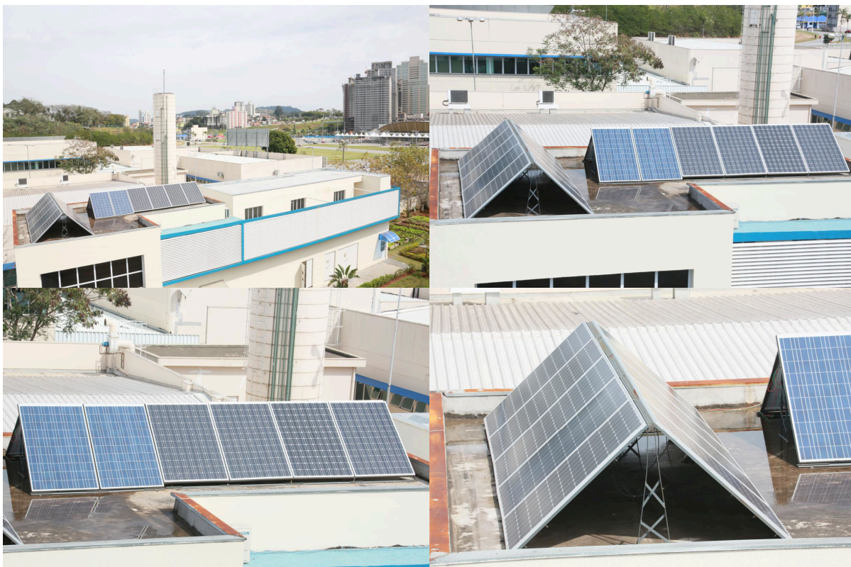
Figura 13 – Sistema de captação de energia solar
